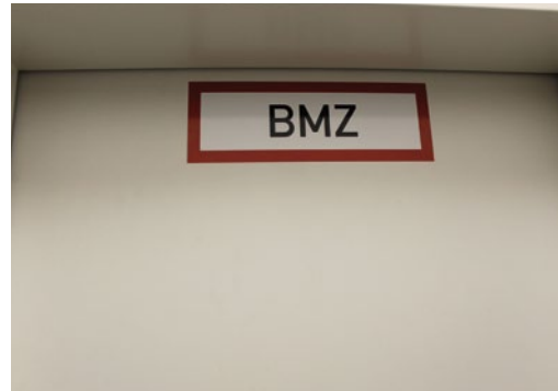
Tür zu einer Brandmeldezentrale – Feuerwehranlaufstelle, wo auch der „Grüne Kasten“ anzubringen wäre (Foto: Städtische Museen Jena)
